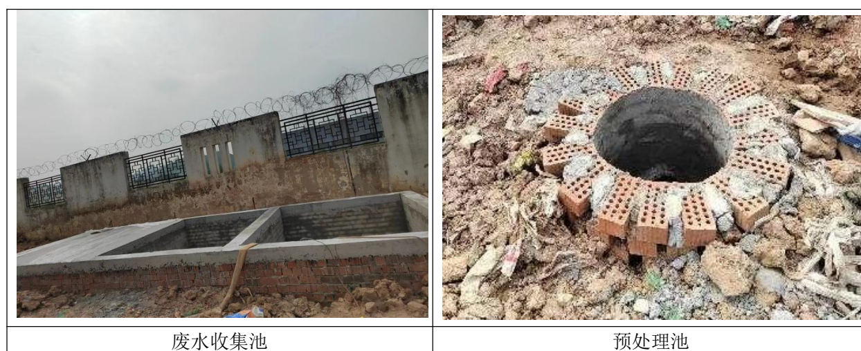
图 3-1 厂区废水处理设施
